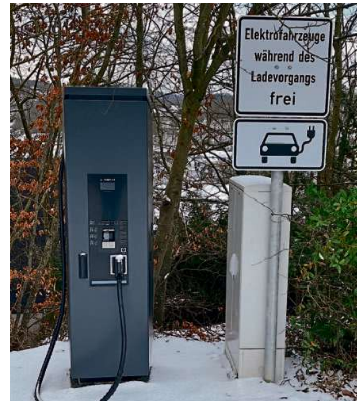
Eine neue Ladestation für E-Autos auf dem oberen Parkplatz der Stadthalle. Hier haben unter anderem auch die Besucher des Krankenhauses (Lahn-Dill-Klinik Dillenburg) die Möglichkeit ihr Fahrzeug zu laden. Foto: E. W. Schramm/Oranienstadt Dillenburg
