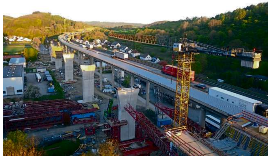
Eins der größten Brücken-Neubauprojekte in der Außenstelle Dillenburg: der Ersatzneubau der Talbrücke Sechshelden. Foto: Implenia
